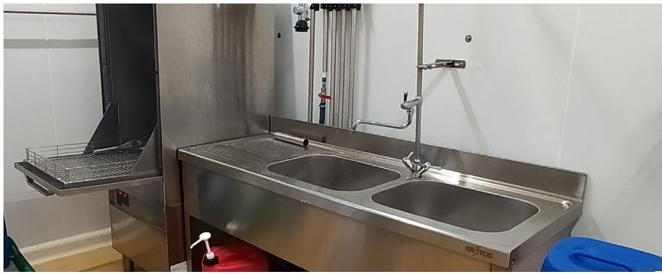
Un nettoyage bien maîtrisé commence par un poste de travail bien agencé et fonctionnel : douchette, robinet, produits à disposition.
