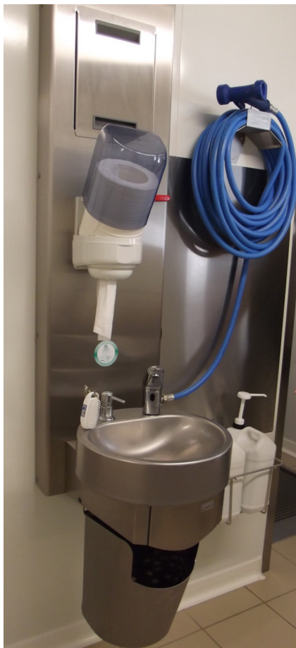
Un poste combiné bien équipé avec lavabo à commande non manuelle et centrale de lavage.
